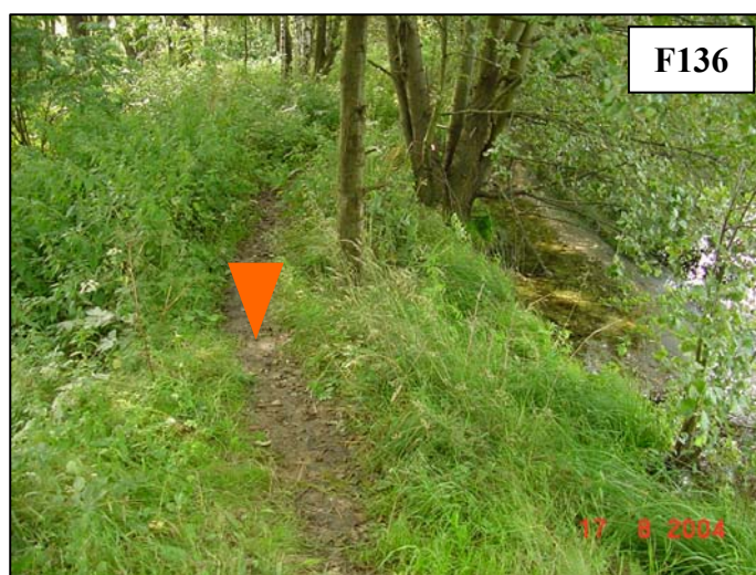
Hráz za požerákem, koruna hráze je úzká - označeno nebezpečné místo - hrozí protržení hráze.
